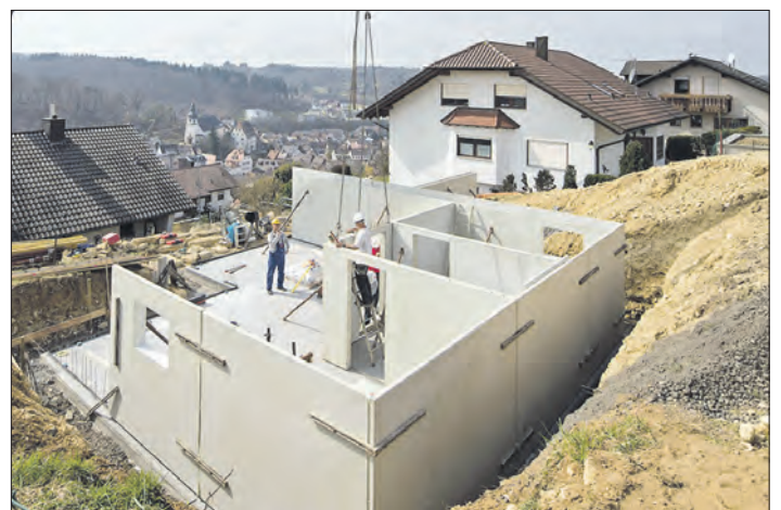
Ein Fertiggeller mit passender Raumaufteilung kann den Wohnkomfort spürbar erhöhen. Werkfoto: GÜF/MB Effizienzkeller
