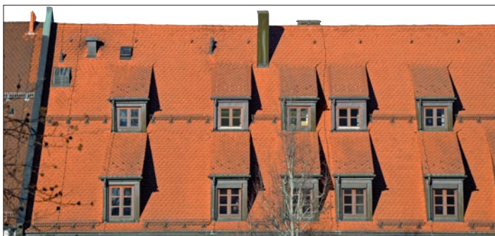
Funktional und schön auch nach vielen Jahren: Ein regelmäßig gewartetes und gepflegtes Dach erfüllt jahrzehntelang seine Schutzfunktionen. Werkfoto: Bayerisches Dachdeckerhandwerk
