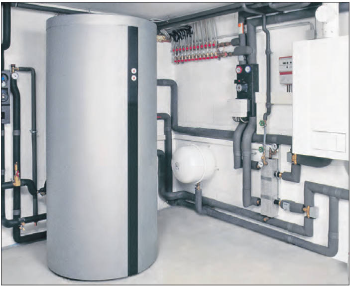
(pb) Bei Hybridheizungen können verschiedene Systeme zur Wärmeerzeugung energiesparend kombiniert werden. Foto: IWO
